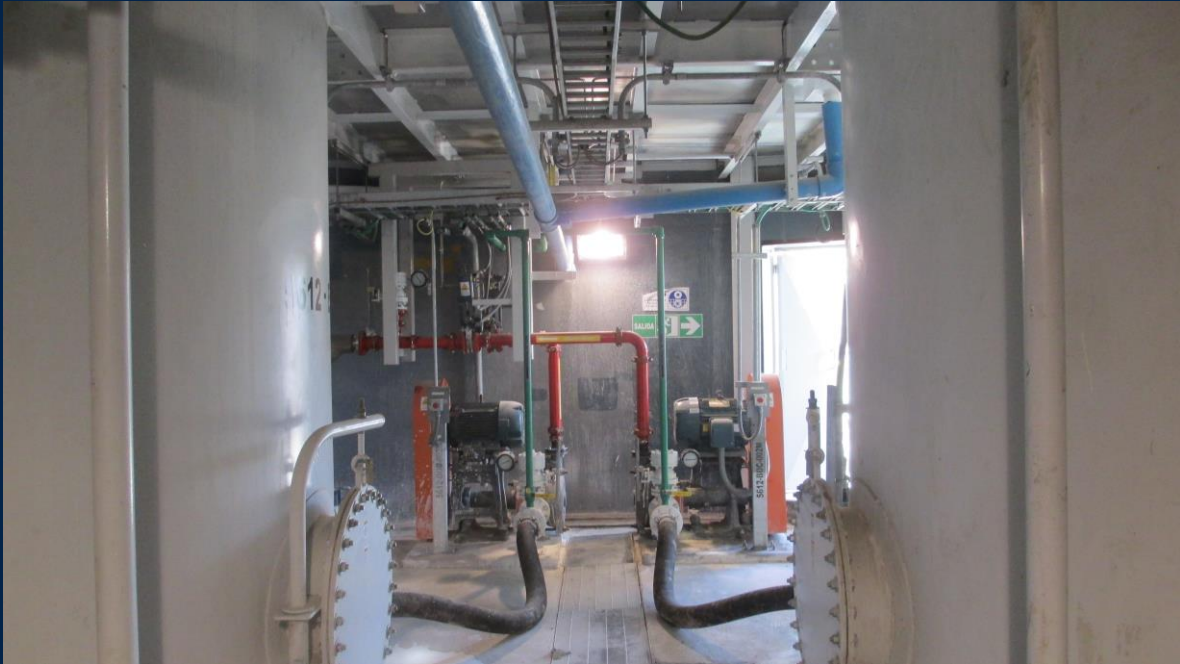
Ilustración 7: Estanques de transferencia de lechada hacia sistema de bombeo
