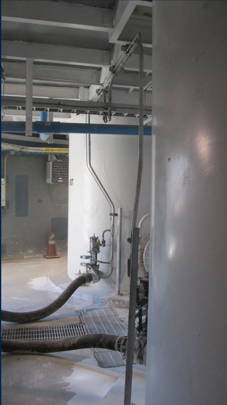
Ilustración 6: Estanques de transferencia de lechada de cal
